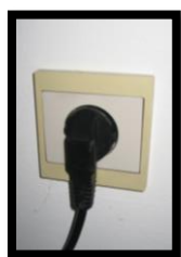
Fig-24 : Raccordement électrique en bâtiment
