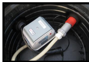
Fig-25 : Raccordement électrique en local technique
